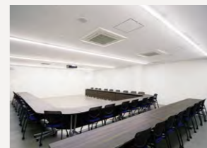
放射線災害も想定した災害対策室には一体型LEDベースライト iDシリーズを採用
