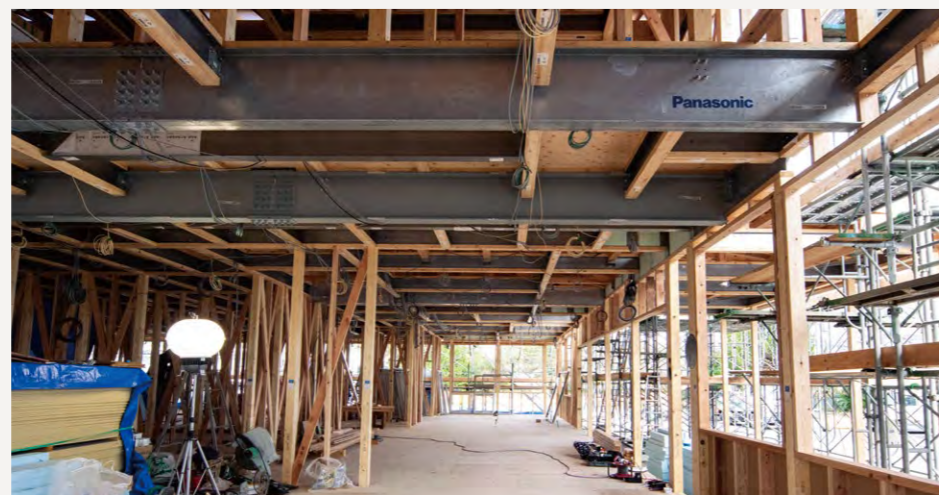
木造で8.55mのスパンを実現する管理棟講堂のグランドテクノビーム
