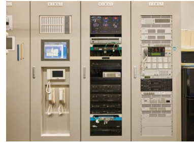
守衛室に設置された照明制御・映像・非常放送設備
