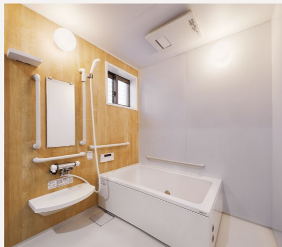
入浴介護が必要な方にも対応できるように 浴室にはアクアハートa-Uシリーズが採用された
