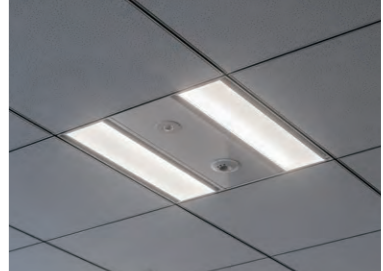
窓際の器具には昼光センサを設けて消費電力を削減
