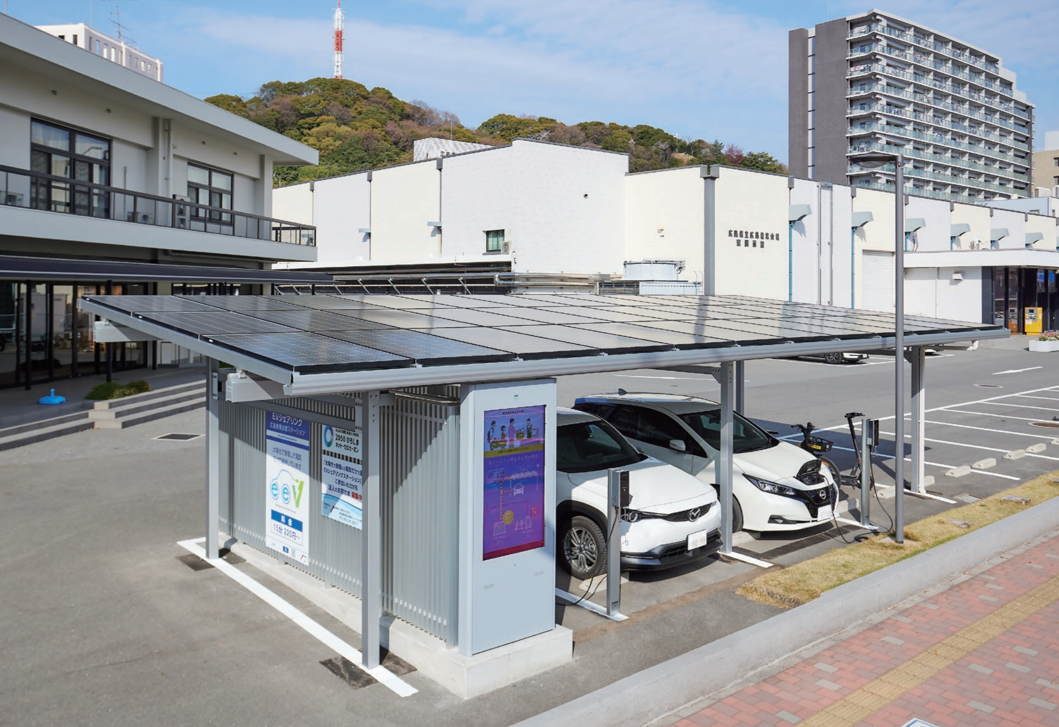
太陽電池モジュール(11.88kW)と蓄電池(38kWh)を備えたソーラーカーポート。サイネージには現在の充電状況とニュースが表示されている
