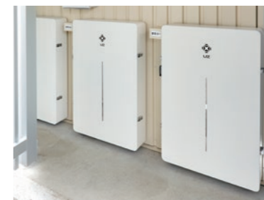
蓄電システム(10kWh×3基) (AZAPA社の実証実験機)
