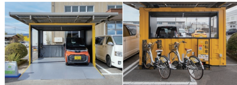
多治見美濃焼卸センター協同組合に設置された「E-Cube」。背後には電動アシスト自転車充電設備
