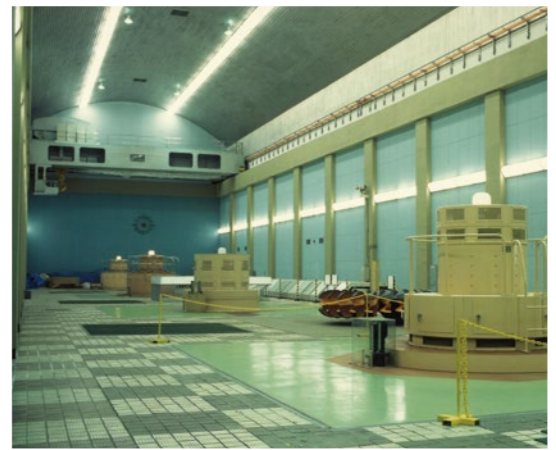
4台の発電機が設置された発電所は高さ33m、幅22m、長さ117mもの巨大空間。メンテナンスのため天井高も確保されている。
