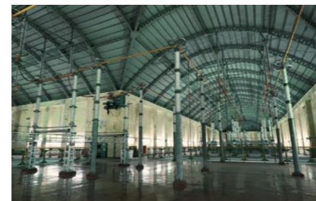
開閉所は送電線などの事故波及防止のため、遮断器をはじめとする装置で送電線に電気を流したり止めたりする。
