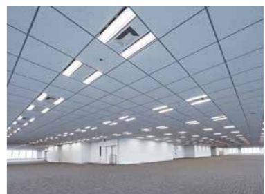
専有面積が約4,000㎡にもほる基準階執務室のシステム天井用照明器具
