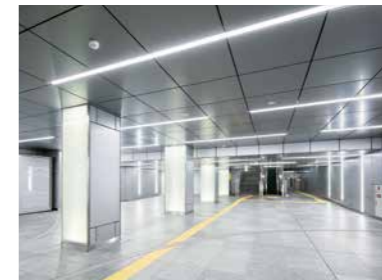
壁面に建築化照明、天井はスリムベースライトが採用された、うめきたエリアと西口を結ぶ連絡通路
