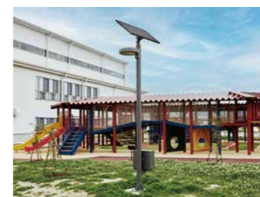
キッススタジアム前に設置されたソーラー街路灯
