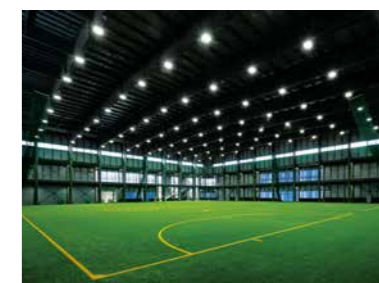
人工芝の屋内練習場に設置された高天井用LED照明器具
