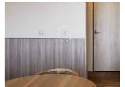
犬に配慮して設けられた腰板コンセントも高い位置に設置
