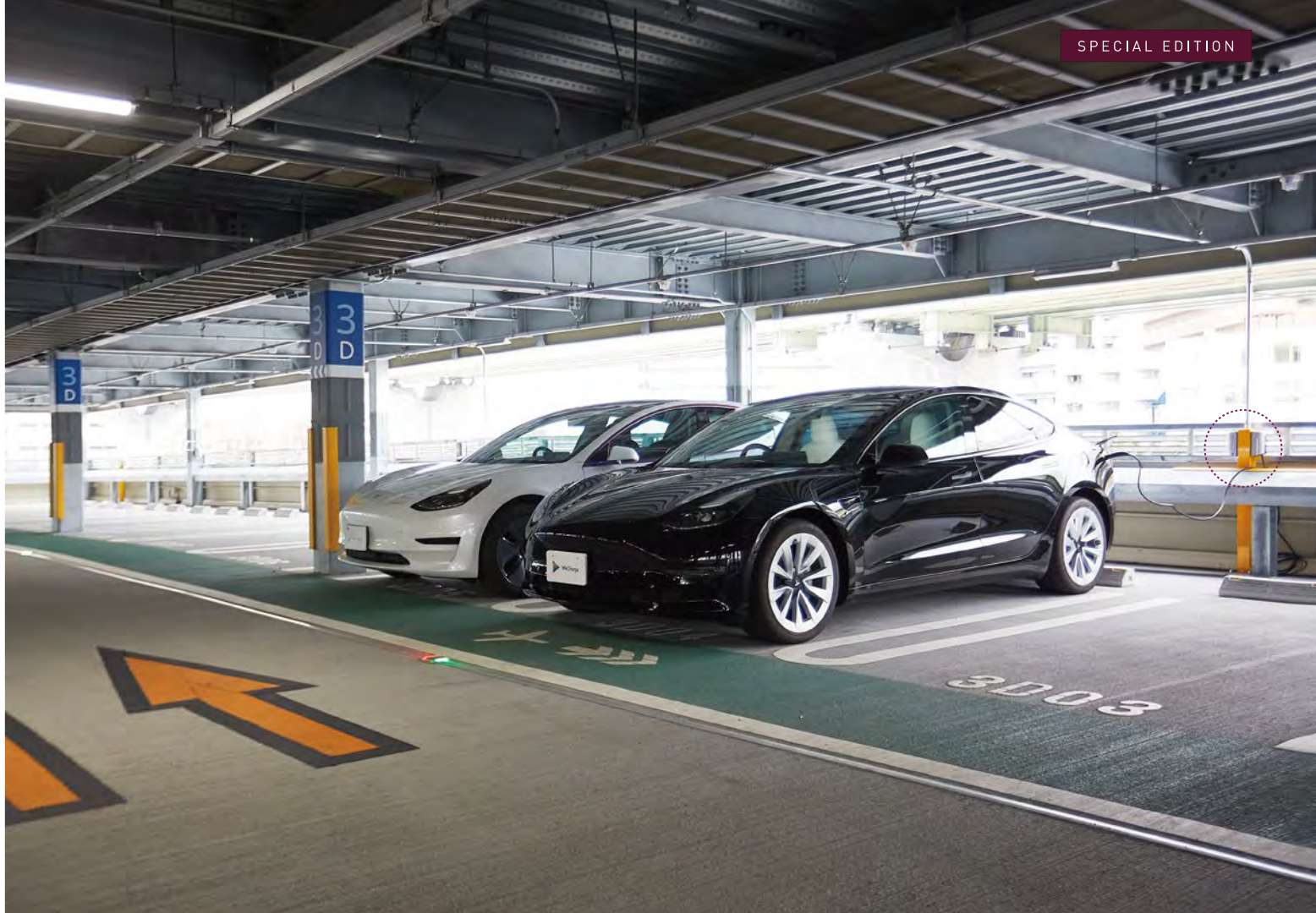
大阪国際空港の北立体駐車場①3階(84車室)および、南立体駐車場2階(100車室)、全184車室に設置されるEV充電用3kWコンセント(写真は北立体駐車場①3階)
