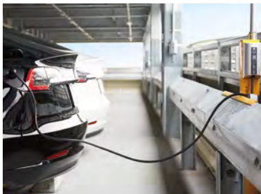
EVユーザーは所有するケーブルを用いてEV充電用コンセントに接続
