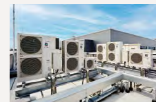
個室用のパッケージエアコン室外機
