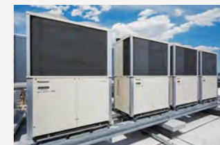
屋上に設置されたガスヒートポンプ (GHP)
