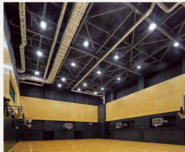
バスケットボールやバレーボールのコートが1面取れる床面積約630㎡のサブアリーナに採用されたLED高天井用照明器具
