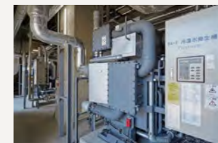
バックヤードの空調用吸収式冷凍機
