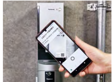
EV充電器の二次元コードを読み込むと充電開始
