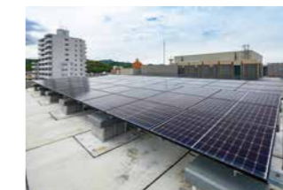
屋上の産業用太陽電池モジュール(295W×106枚 31.27kW)
