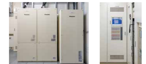
2~4階に設けられたパワーステーションダブル(11kW×3台)と産業用蓄電池(5.6kWh×6台)
