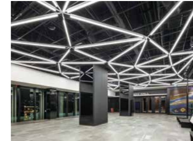
一体型LEDベースライト「sBシリーズ」で構成された6階中日ホールロビーの「ポリゴン天井」
