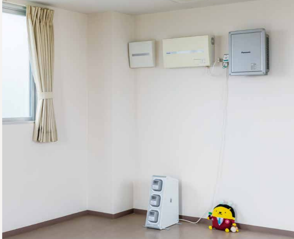
地上高が約6.4mあり、地域住民35名が避難できる。停電時には太陽光発電システムの自立運転で「イーブロック」を充電し、災害時には地域住民のスマートフォンの電源となる（設置：2023年度）
