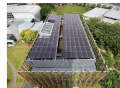
屋上一面に設置された太陽電池モジュール。左端中央は内階段のトップライト
