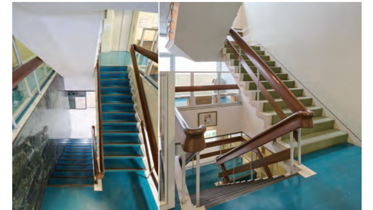
Pタイル(樹脂製タイル)を敷いた床。定期的にワックスをかけてつやを保っている。ステップや木製手すりも竣工当時の姿で使われている。4階への階段(右)は絨毯敷き。
