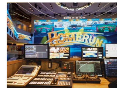
照明・音響・映像設備を統合制御する「KAIROS」操作卓
