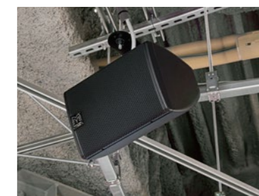
アリーナ各所に設置されたスピーカーシステム
