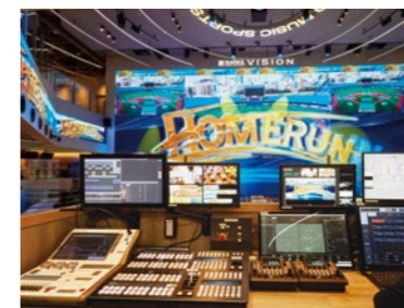
照明・音響・映像設備を統合制御する「KAIROS」操作卓
