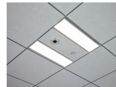
基準階執務室のシステム天井用照明器具はDALI®対応
