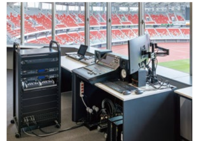
5階場内放送室に設置された調光操作卓「TESTA」（中央奥）とオーディオミキサー（右）
