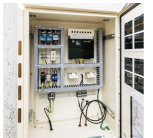
演出プログラム自動再生器が組み込まれた制御盤
