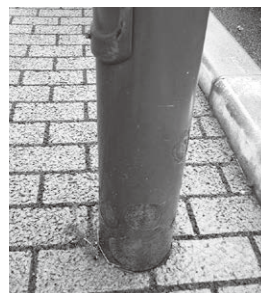
ポールの腐食した例
