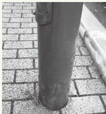
ポールの腐食した例
