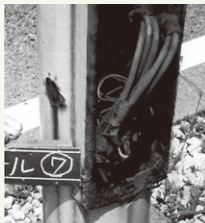
開口蓋を外した状態
