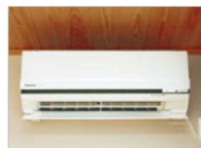
キッチンに設置したAiSEG対応エアコン。
