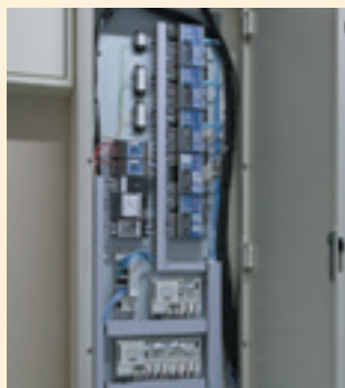
▲1階のエミット・フル2線計量パネルを組み込んだ計量インターフェース盤
