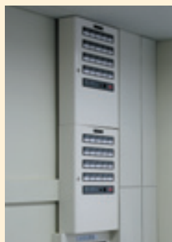
▲研究室内実験盤の漏電状態を表示する警報表示盤 (ネオアラーム)
