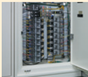
▲警報表示盤への出力T/Uを組み込んだ盤
