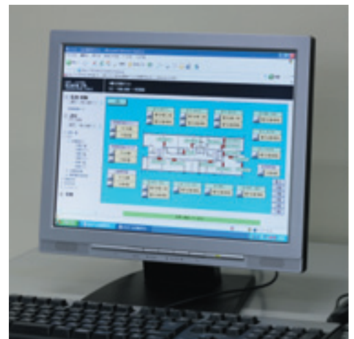
▲管理室のパソコンから研究室毎の電力量や給水量、設備警報の確認が可能
