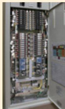
▲フロアごとのリレー制御盤
