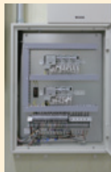
▲電力チェッカーを組み込んだ盤
