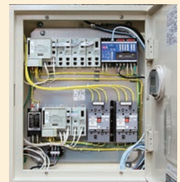
▲Webサーバ、多回路電力チェッカーを組み込んだエミット・フル2線インターフェースパネル。
