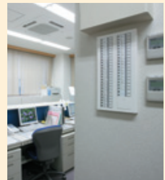
▲管理室内の集中操作スイッチ
