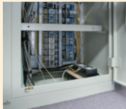
▲エミット・フル2線計量パネルを組み込んだ管理室盤
