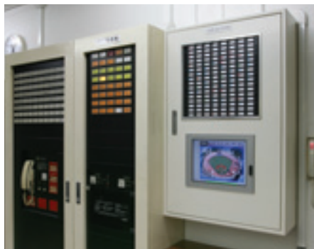
▲防災センターに設置された エミット・フル2線操作パネル（インターフェース内蔵）。 タッチ式パネルコンピュータで簡単操作を実現。
