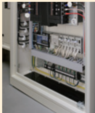
▲Webサーバ、多回路電力チェッカーを組み込んだ計量・分電盤
