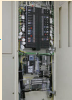
▲伝送ユニットを組み込んだ内器
