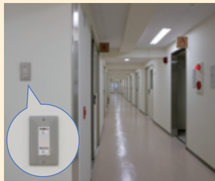
▲廊下に設置されたリモコンスイッチ
