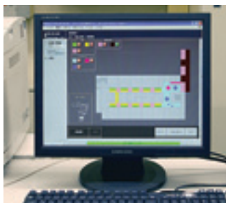
▲監視室のパソコンから共用部の照明監視・制御が可能
