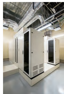
コンパクトに収まった照明電源室
