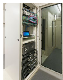
V4スタジオ ネットワーク制御盤
