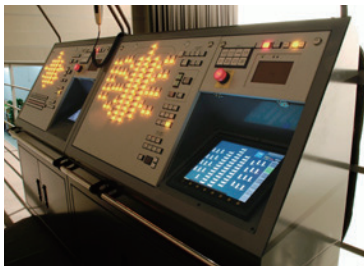
M3スタジオ 昇降操作盤
