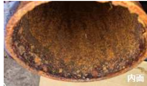
写真2 ポール内面の錆状態
