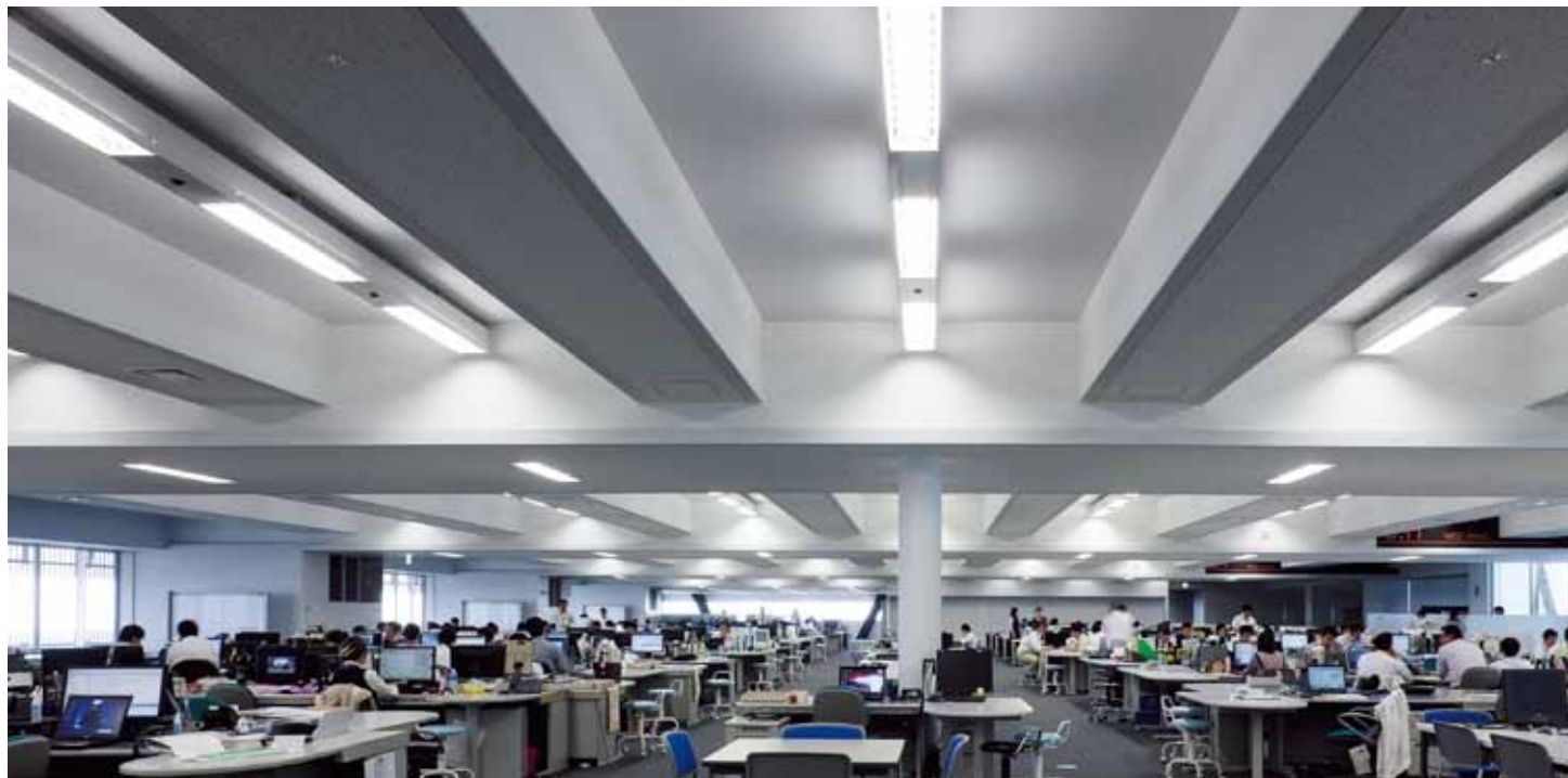
「アイシン・エイ・ダブリュ 技術センター」6階西ウイング執務室。コストを抑えるために階高は抑えながら、最大3,700mmの高天井を確保している。照明器具の反射板側面にスリットを入れることで、縦方向のダクトルートとなっているPC梁にも配光し、天井全体を明るくしている。照明器具のユニットにはスプリンクラーを内蔵し、3,000m 2 の大平面を分割せずに使用している。
