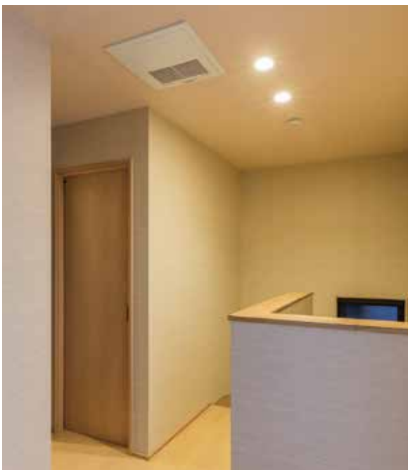
2階廊下の天井に埋め込まれた「熱交換気ユニット」。 本体は天井裏のため、インテリアとも違和感なく調和している
