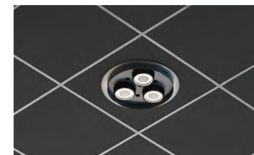
器具回りのつばを特注で作し、埋め込まれた天井部のLED照明。
