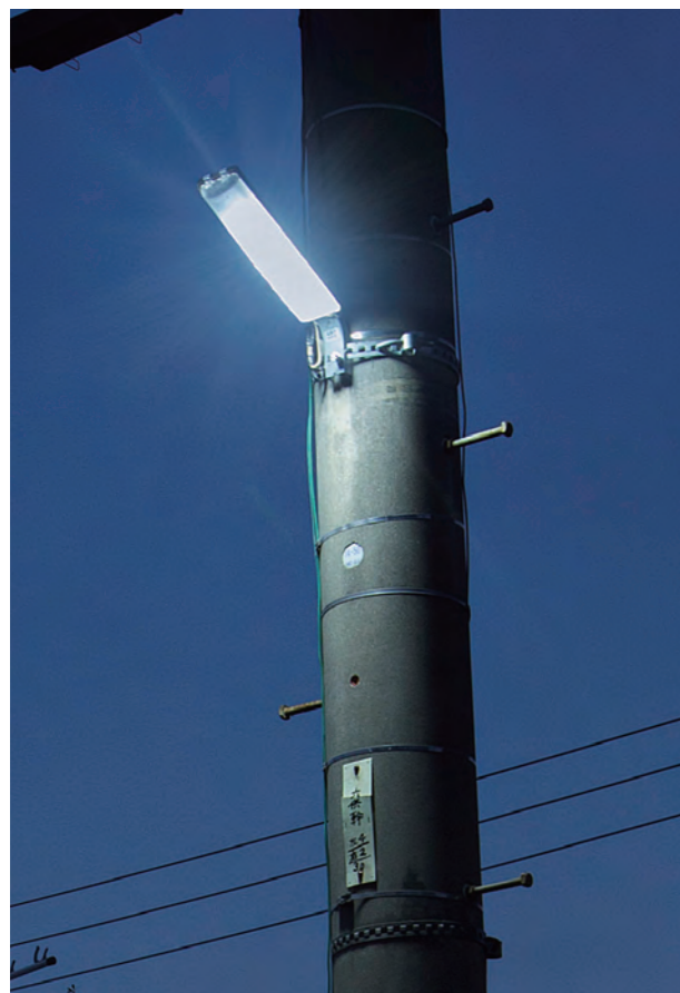
10VAタイプと20VAタイプの2種類の防犯灯を設置。
