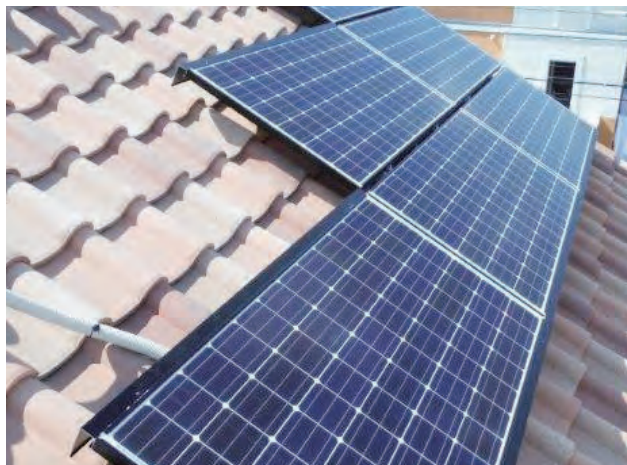
発電効率の良さからパナソニックの太陽光発電システムHIT®、そしてスマートHEMS®が選ばれました。
