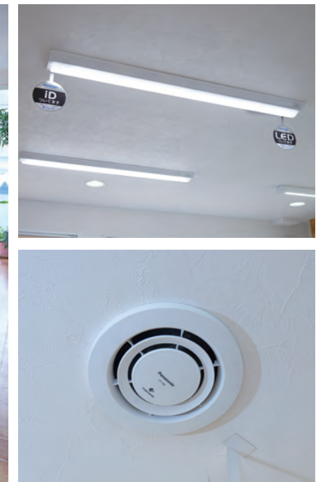
事務所に設置されたLEDベースライトiDシリーズとエアコン。
