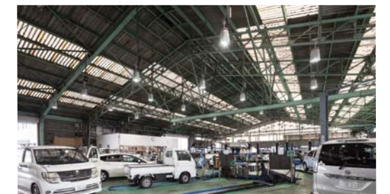
▲ サービス工場内にもLED高天井用照明器具をご採用。
