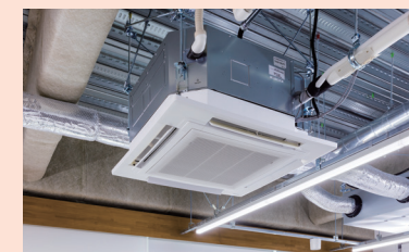
エアコン室内機
