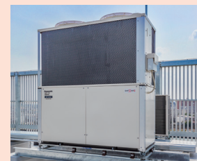
ガスヒートポンプエアコン室外機
