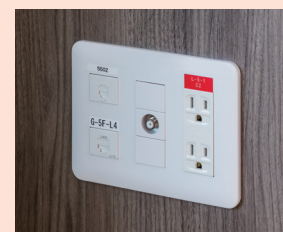
コージェネレーションシステムと連携し、 災害時に使用できるコンセント
