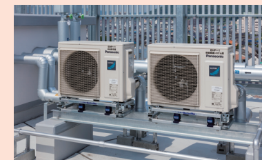
電気ヒートポンプエアコン室外機
