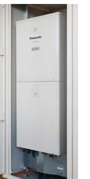
玄関横に設置された370Lエコキュート
