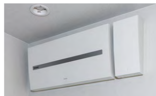
住宅用分電盤(左)とエネルギーモニター用ユニット(右)
