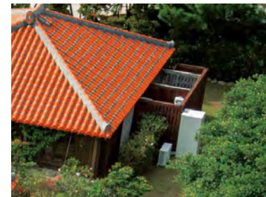
「かたあきの里」の7棟にネットワーク型エコキュートを設置したVPP (Virtual Power Plant) の実証実験
