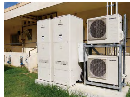
市営住宅に設置されたネットワーク型エコキュートは需給調整と温水提供を兼ねる
