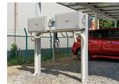
2台のパワーコンディショナ (5.5kW, 4.4kW)
