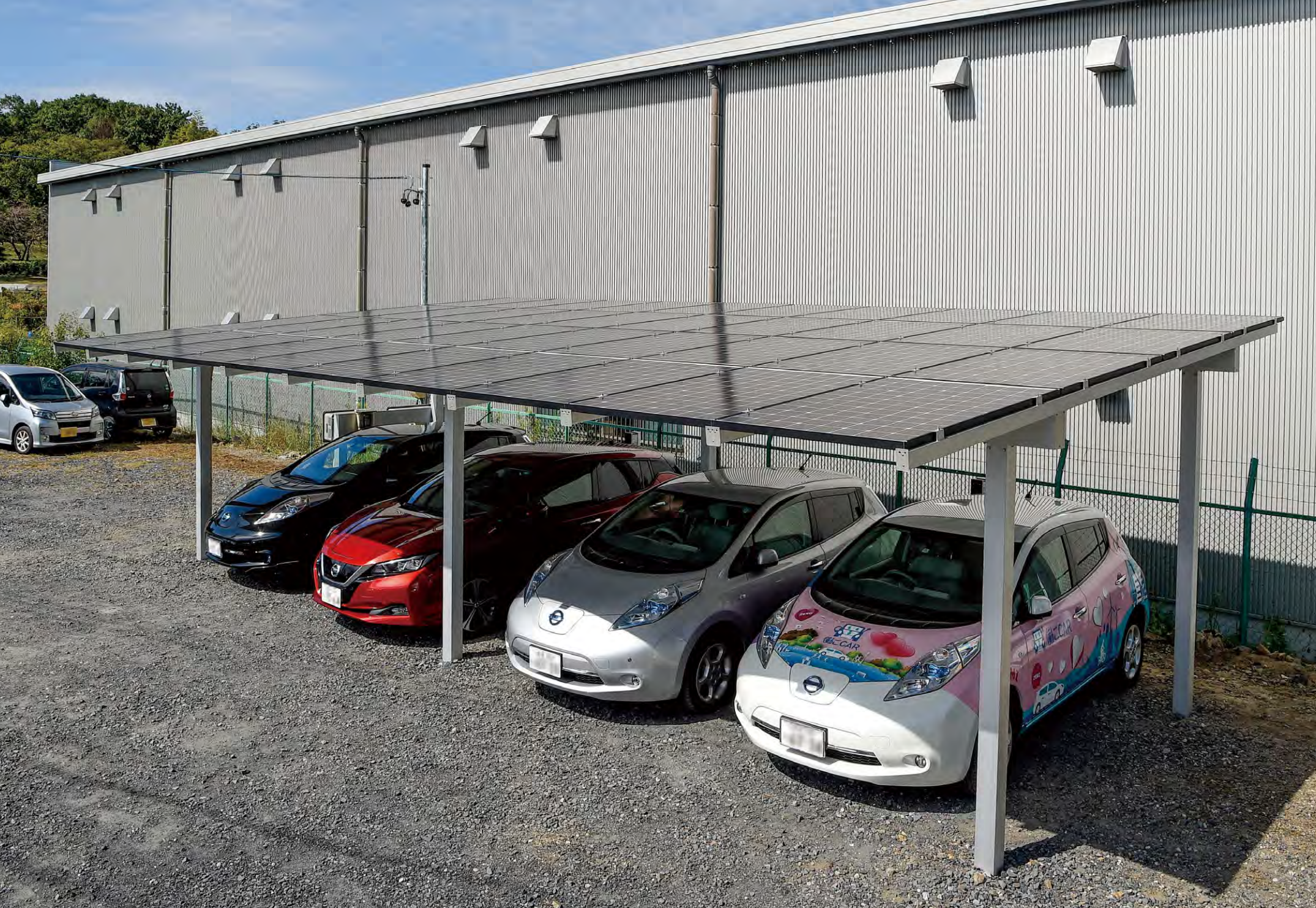
太陽電池モジュールHIT325A 13kWを搭載したソーラーガレージ。駐車した電気自動車4台に充電するとともに、電力逼迫時には電気自動車を蓄電池として利用する計画
