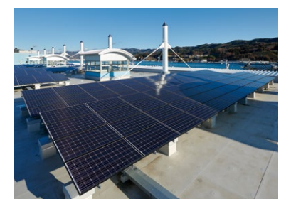
屋上に設置された太陽電池モジュール
