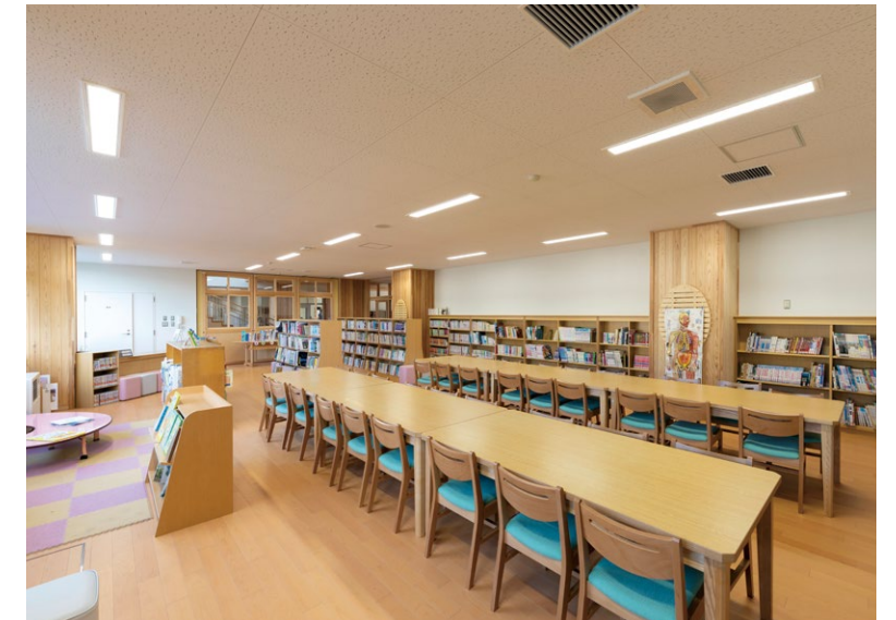
図書室に設置された一体型LEDベースライト iDシリーズ
