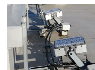
支柱を照射するライトアップ用LED投光器
