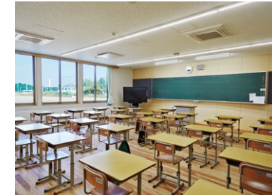
一体型LEDベースライト iDシリーズが採用された普通教室
